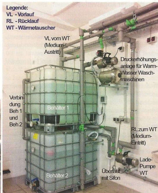
Wassertechnische Anlage mit Speichersystem.
